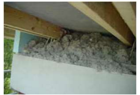
Bild 10: ... und das Ausblasen des Dachzwischenraumes mit Zellulose in der Dicke von ca. 25 cm
